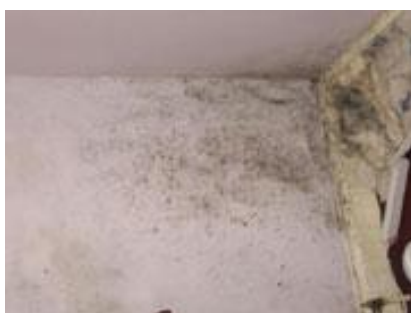
Fig. 2 : Formation de moisissures sur les murs et le plafond qui révèlent une mauvaise isolation thermique et une mauvaise ventilation.
