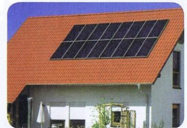
photo 1 : panneaux solaires (cellules photovoltaïques) sur un toit (source : Stoll)
