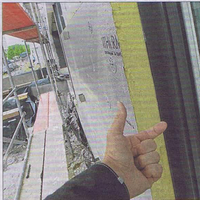
Isolierfassaden im Aufwind. Nicht nur die Klimaschützer sondern auch Handwerker dürften die neuen Bestimmungen freuen. (FOTO: MARC WILWERT)
